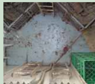
3,5 meter er der fra lugens overkant til dørken, så det er ikke så underligt, at maskinchefen kom slemt til skade ved faldet.
