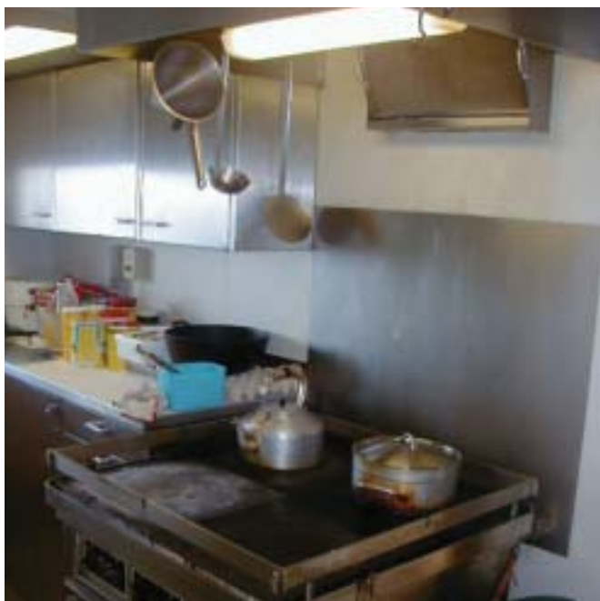
Eksempel 5: Kabys i mindre lastskib. Ovn er en del af komfuret. Emhætten sikrer, at stegeos og damp fjernes fra kabysen.
